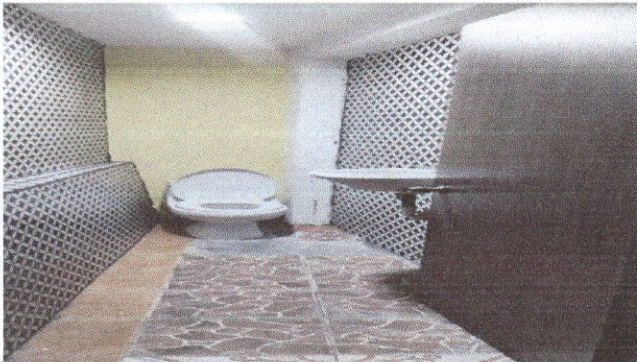
Foto 3: compra e instalacion de sanitario y lavamanos cernido y repello de paredes, azulejo,pintura, drenaje instalacion de puerta prefabricada.
